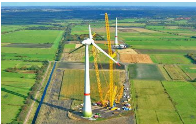
Германия – Энеркон Е-126, самый большой ветрогенератор в мире. Общая высота конструкции 198 м. Мощность 7,5 МВт
